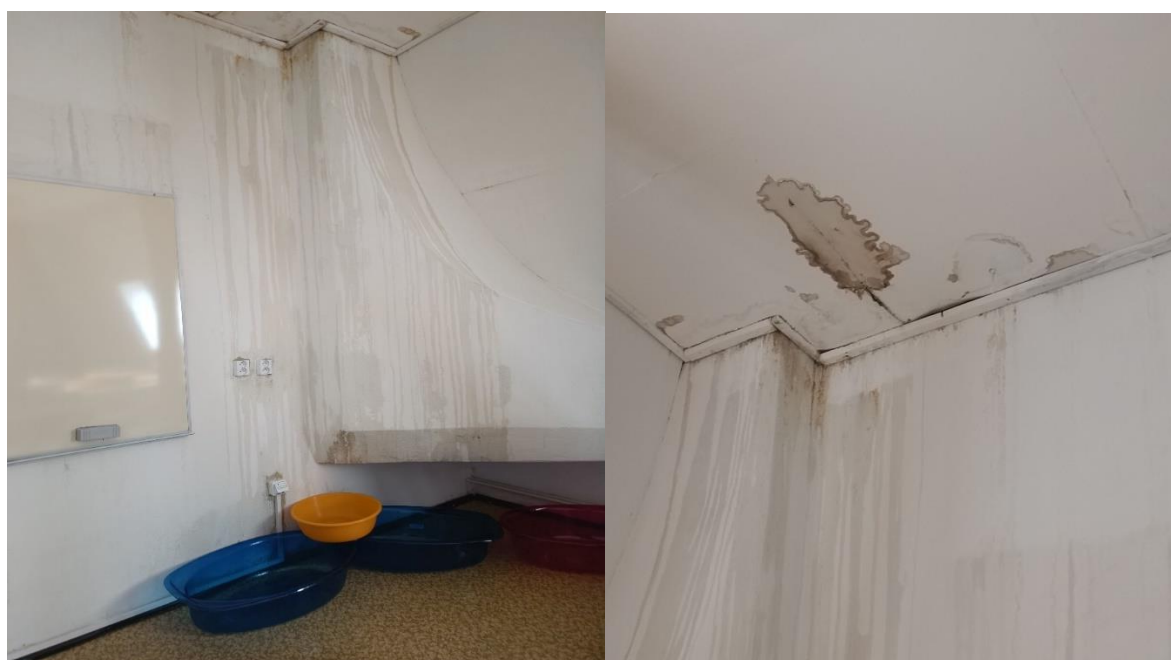
Učebna ve 4. NP, kam zatéká při velkých deštích voda
