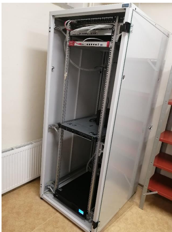
Nový server v ZŠ Meziboří
